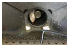
燃焼ポット給気口の清掃
