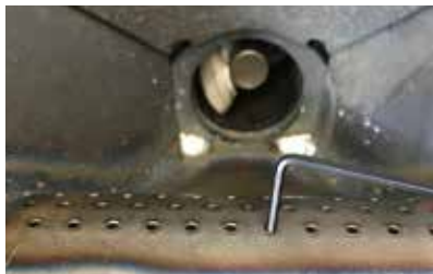
燃焼ポット給気口の清掃
